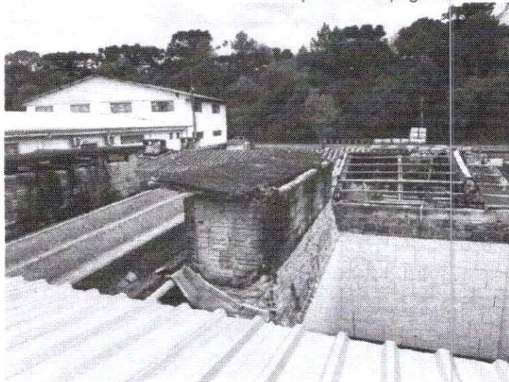
Figura 6 - Telhado sobre a cozinha da área principal do Centro comunitário, danificado após destelhamento por conta de fortes chuvas. Na imagem também fica evidenciada as patologias nas paredes das chaminés das churrasqueiras internas.
