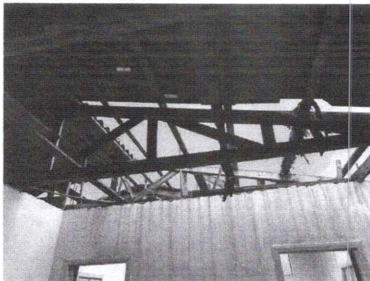
Figura 5 - Telhado da churrasqueira dos fundos após fortes chuvas que causaram o destelhamento e a quebra de telhas
