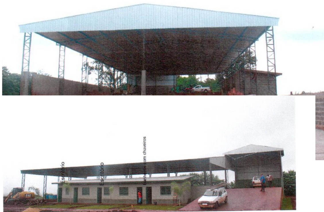
Figura 05: vista frontal da parte administrativa do barracão de triagem e aos fundos o local onde funcionará a operacionalização dos resíduos.
