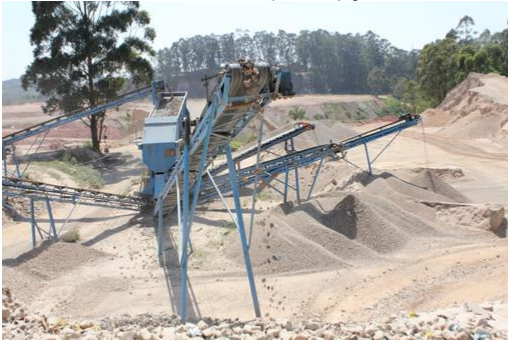
Figura: Usina de Reciclagem de Entulhos
